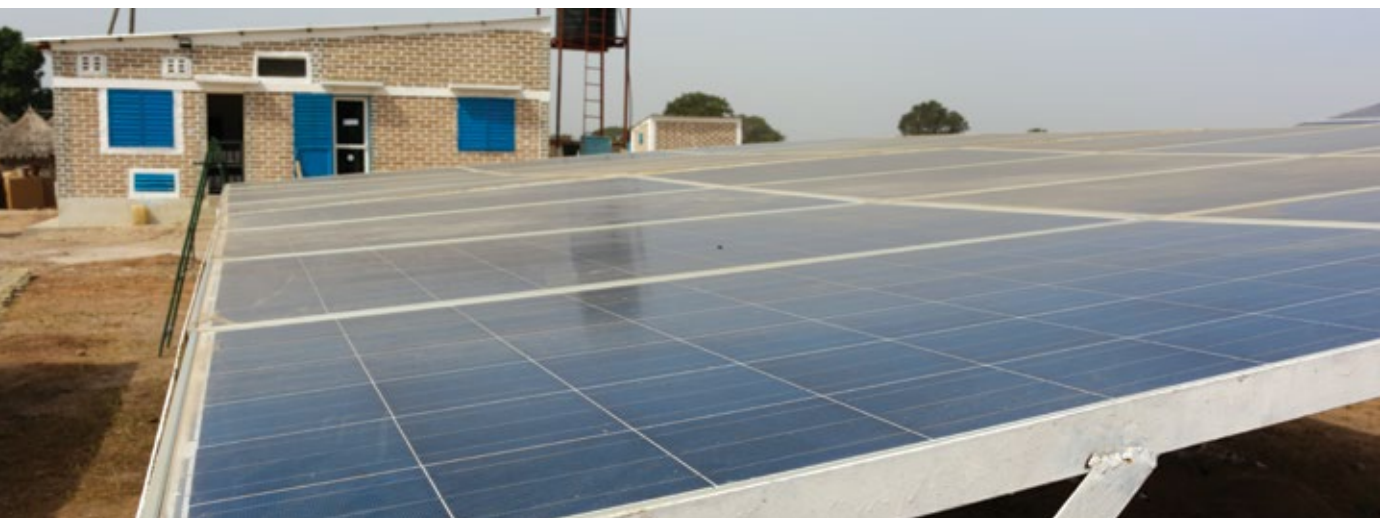
Panneaux solaire sur la plateforme de Diambanouta, Kolda
